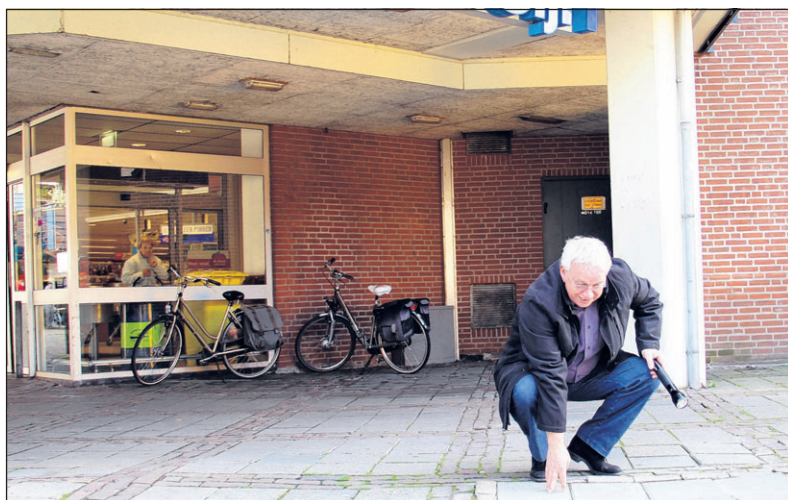
Jan de Boer bij een van de vele plekken bovenop de parkeergarage waar de bestrating los zit of wegzakt. foto Florence Imandt
